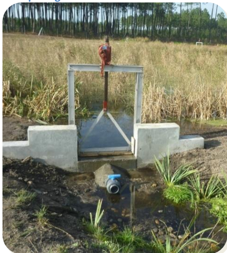
Martellière avec vanne permettant vidange (réalisation SUEZ)
