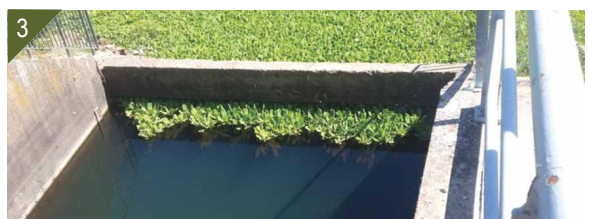
1- Localisation de l'aménagement de Vallabrègues. 2 et 3 - Canal colonisé par la Laitue d'eau.
